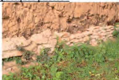
Mur avant réfection
